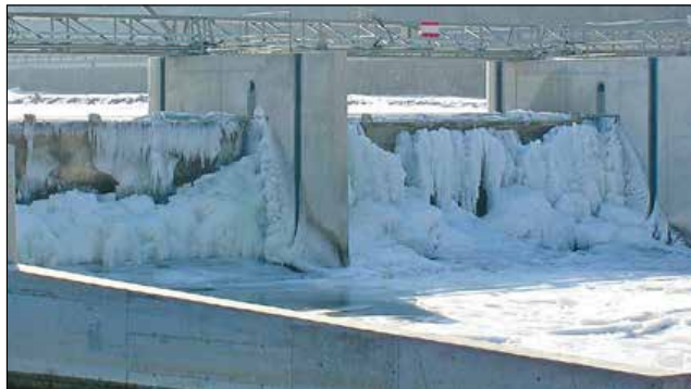
Zamrzlá malá vodní elektrárna Hronská Dúbrava. Voda v malých vodních elektrárnách může často zamrznout a způsobit ledové záplavy, které ohrožují obyvatele a jejich domovy v okolí. Autor: Jaroslav Gazdík
